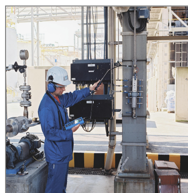
◆ 配管やバルブの漏れ検知 (蒸気漏れ、エア漏れ、 真空漏れ、ガス漏れ等)
