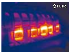
絶縁体の欠陥
